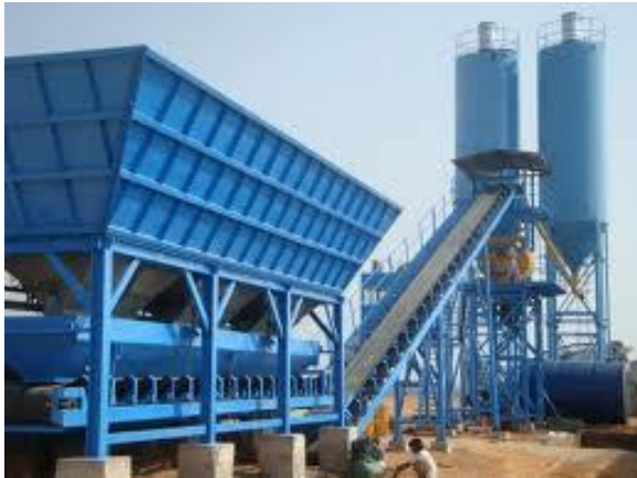
Trạm trộn Bê tông
